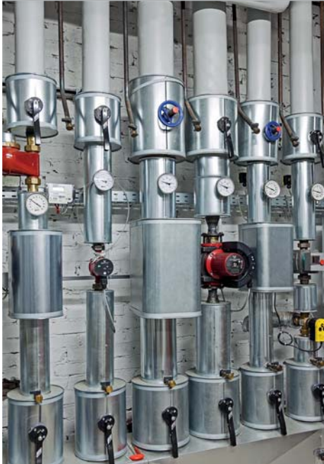
Chauffage à distance / Société d'approvisionnement en énergie
