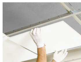
Les panneaux sont démontables individuellement
